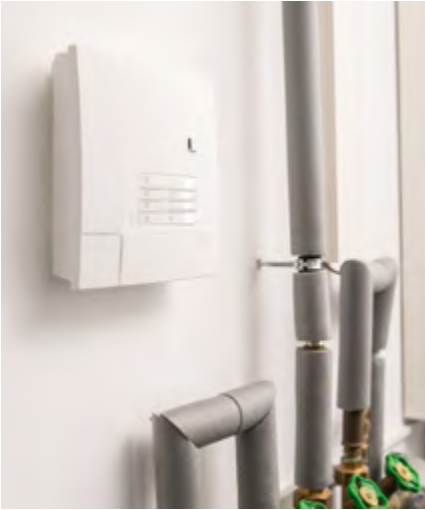
^ Zentrale einer Alarmanlage im Haustechnikraum
