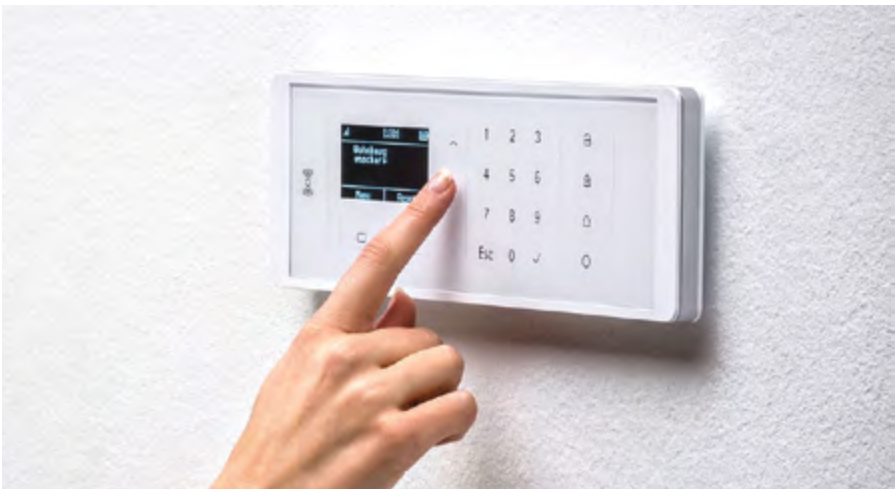
↗ Stationäres Bedienteil einer Alarmanlage mit Smart-Home-Funktionen
